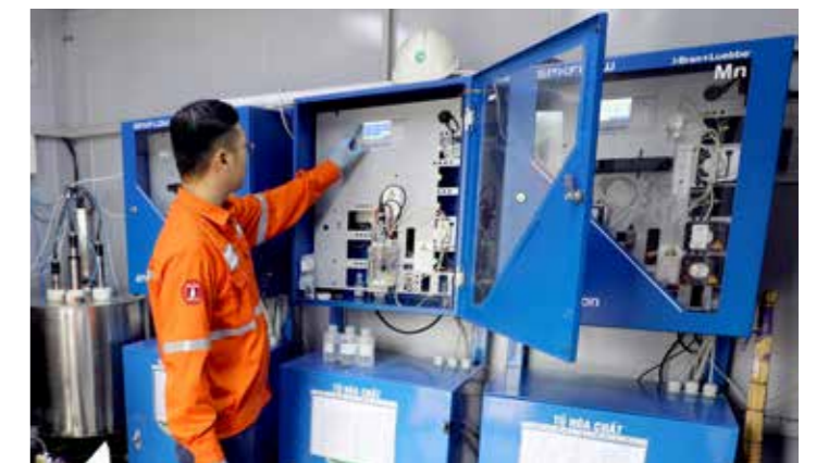
Trạm quan trắc nước thải tự động tại Núi Pháo
